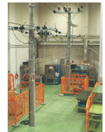
配電線模擬電柱
