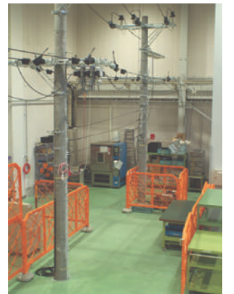
配電線模擬電柱
