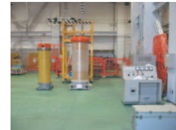
検電器試験装置
